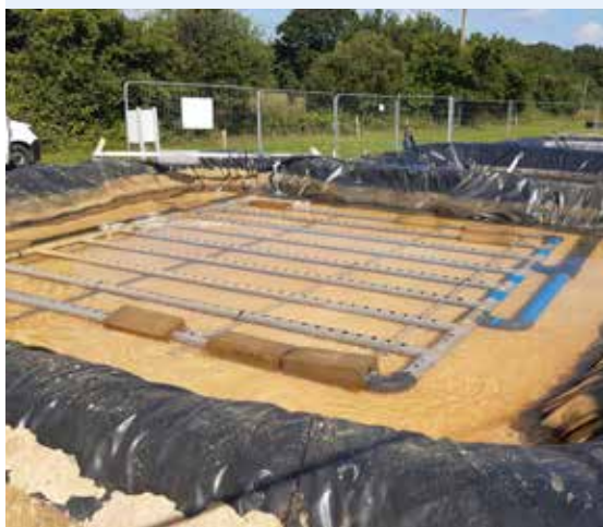
Unité provisoire de traitement de l'eau pompée à Sion-les-Mines
